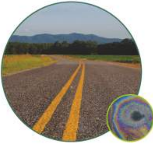
Asfalttaki petrol kalıntısı
